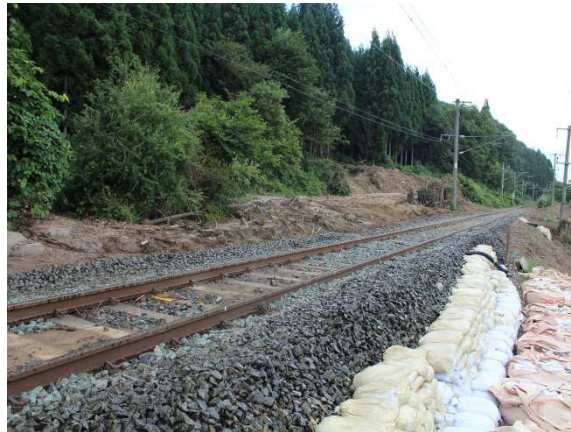
写真 4.26 えぐられた道床の仮復旧。この付近で「こまち」は徐行運転。
