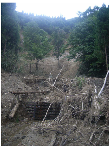
写真 4.27 満砂状態の鋼製ダムを越流した崩壊土砂・倒木
