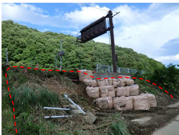
写真 4.11 R46 号線の道路盛土の崩壊状況。土中式防護柵の破損と道路交通情報の基礎部が洗掘された状況。基礎部は大型土のうによって応急対策。
