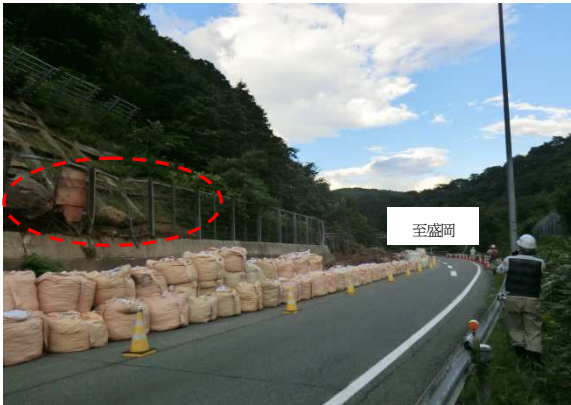
写真 4.13 上方斜面からの崩壊土砂及び落石等に伴い、重力式擁壁の落石防護柵の破損状況。経約1mの巨石が柵の箇所へ落下している。
