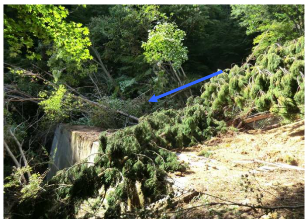
写真 4.28 溪流末端部に構築された砂防ダム (L=47.5m,H=9.5m, 1987 年完成)の状況。上流部で多数の山腹崩壊により土石流が発生しダムを越流。
