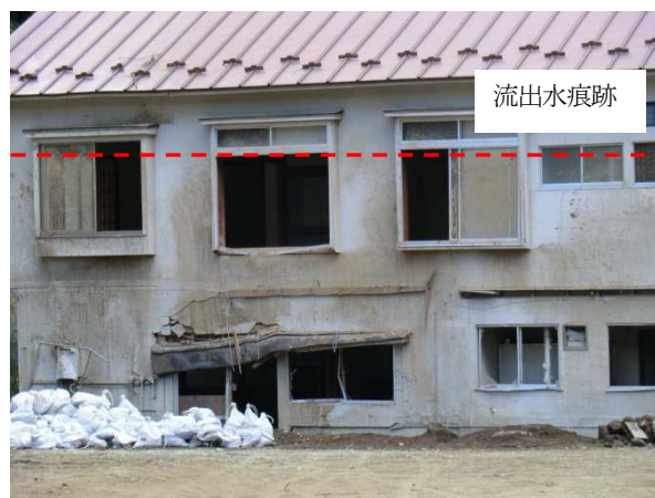
写真 4.30 土石流の直撃を受けたアパートの損壊状況。2 階付近まで土砂が流れ込んだとみられる。
