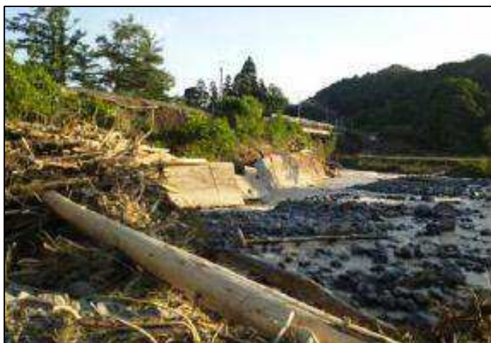
写真 4.18 土留め壁の崩壊 (赤湊駅～田沢湖駅間)
