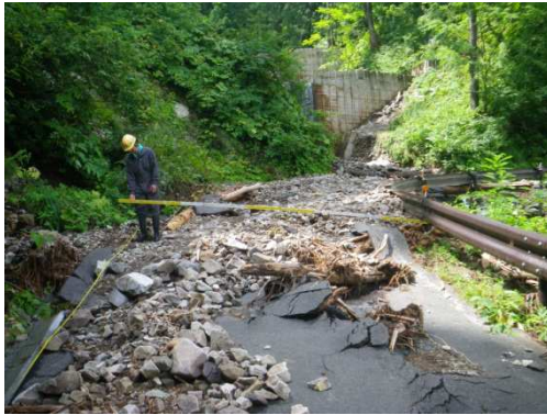
写真 5.26 治山ダムを乗り越えた土石流堆積物
