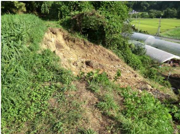
写真 4.1 斜面崩壊の状況。斜面高さ約 9m，崩壊幅約 5m，斜面長約 20m の規模。
