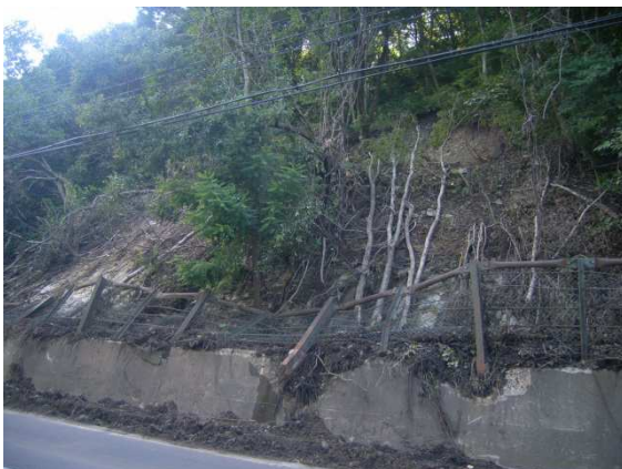
写真 5.43 表層崩壊箇所全景
