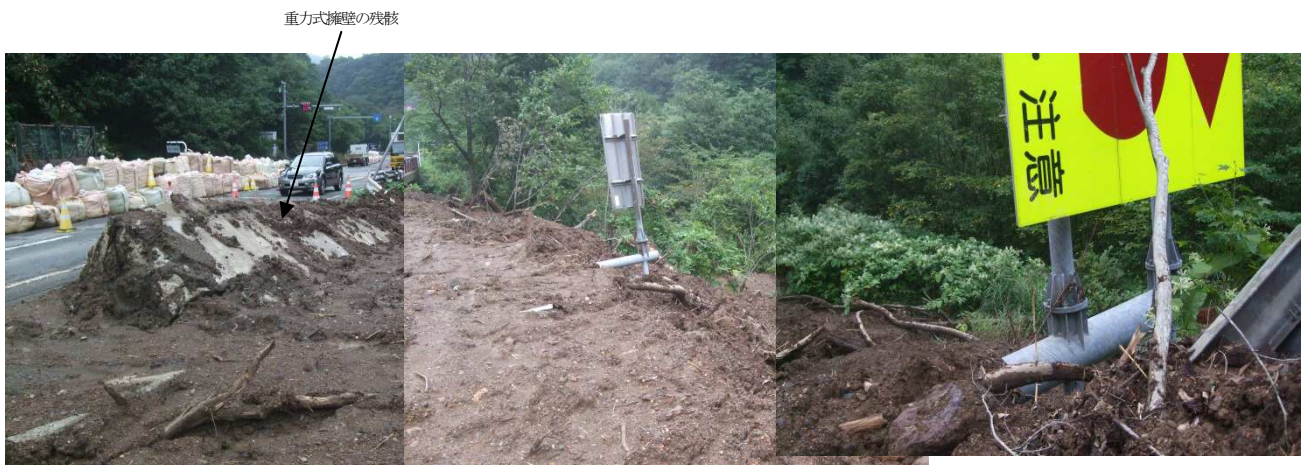
写真 4.15 崩壊土砂により重力式擁壁がR46号線の対岸まで押し出された状況。交通標識等も谷側に押し出されて倒壊。
