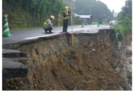
写真 5.37 崩壊した土砂は礫を含む砂質土よりなる
