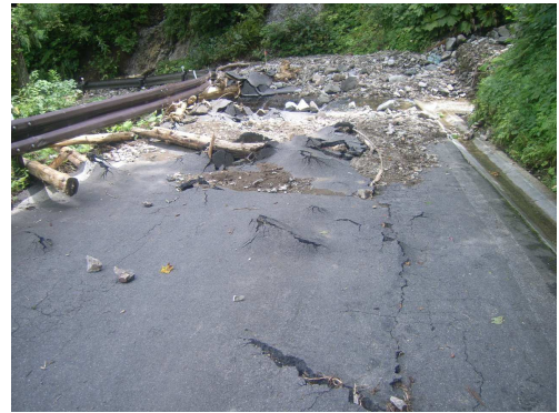
写真 5.27 アスファルト路面の変状
