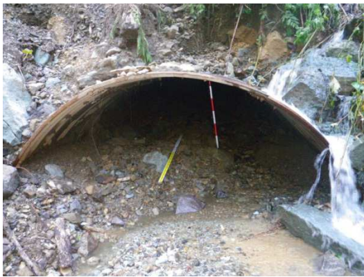
写真 5.32 土砂礫によって閉塞された横断暗渠
