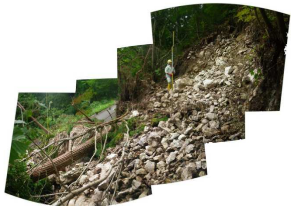
写真 5.21 斜面上部の崩壊土砂礫
