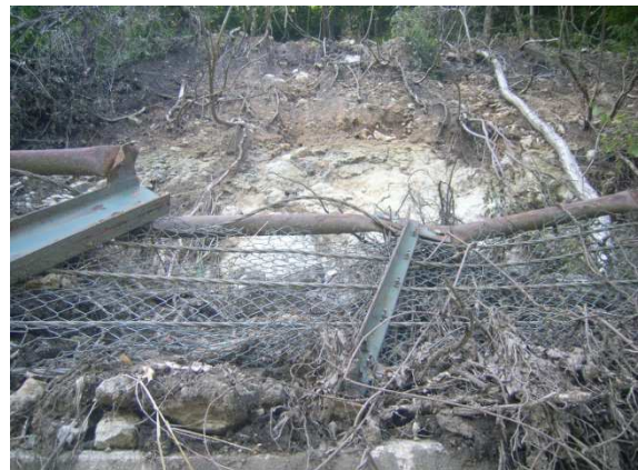
写真 5.44 倒壊した落石防護フェンスと表土類下の岩盤
