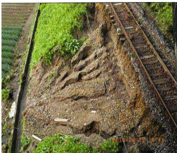
写真 5.17 盛土のり面の崩壊
