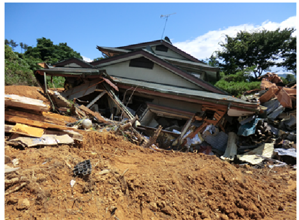
写真 4.4 倒壊家屋の側面の状況。家屋は崩壊土砂に押され谷側方向に傾斜。
