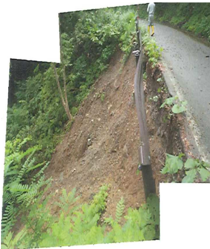
写真 5.39 表土類の崩壊に伴う路肩決壊
