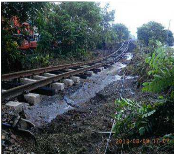
写真 5.15 盛土の流出により宙づりになったレール（長さ約 30m）
