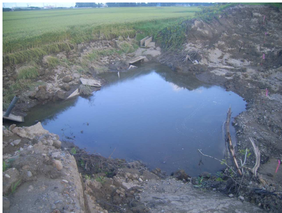
写真 5.47 破堤箇所全景 (被災延長約 30m)
