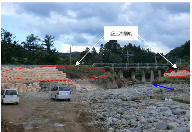
写真 4.22 河川の閉塞により鉄道軌道付近まで水位が上昇し軌道盛土を洗掘した状況。応急対策として大型土のうが4~6段積まれている。
