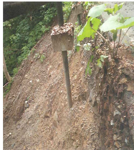
写真 5.40 宙吊りになったガードレール
