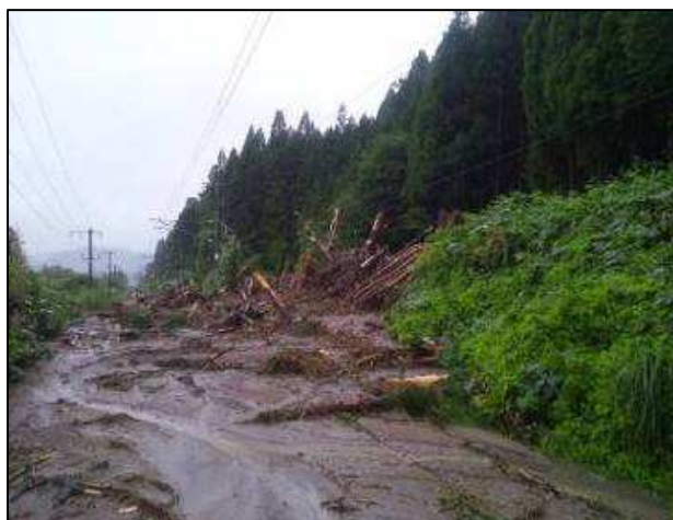
写真 4.17 土砂流入 (春木場駅～赤湊駅間)
