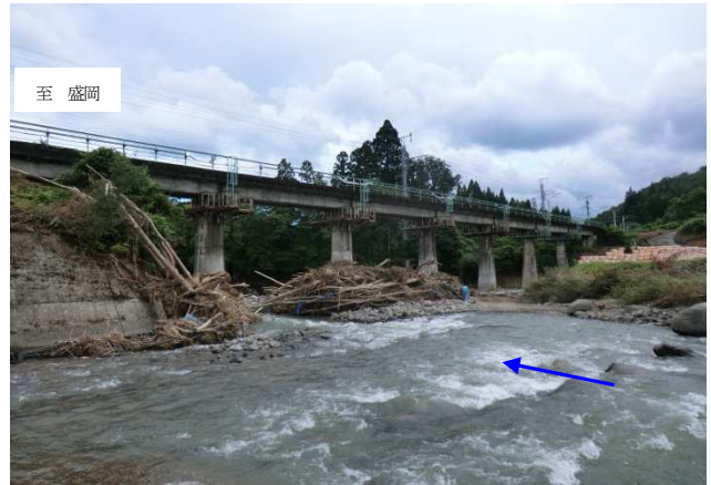
写真 4.21 橋脚間が多量の流木により閉塞している状況
