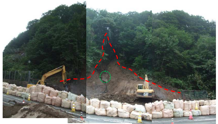
写真 4.14 当該路線沿いには、数箇所の大小の山腹崩壊地が分布するうちの、最大規模の箇所。高さ約45m。崩壊斜面下方に山腹土留工のコンクリートの残骸が見られる。
