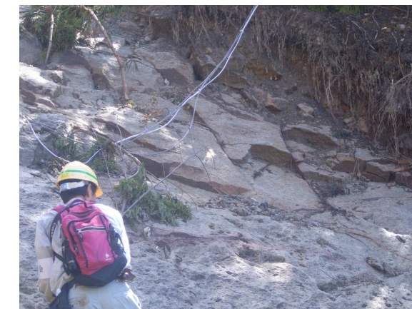
写真 5.8 崩壊域側面の火山礫凝灰岩（節理発達、表面風化）
