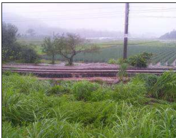
写真 4.16 道床流出 (春木場駅～赤湊駅間)
