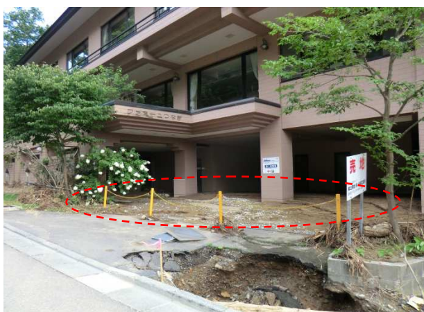
写真 4.29 温泉施設の 1 階の駐車場に堆積した土石流堆積物の状況。写真手前は、流水によって道路下が吸出しを受け陥没した状況。
