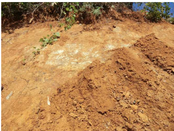
写真 4.7 崩壊面の接写状況。流れ盤を呈する。
