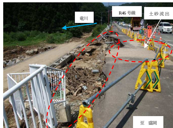
写真 4.10 安栖沢の氾濫によって R46 号線を越し道路盛土が洗掘、崩壊した状況。写真左手奥の側道や荒地に氾濫土砂が堆積。
