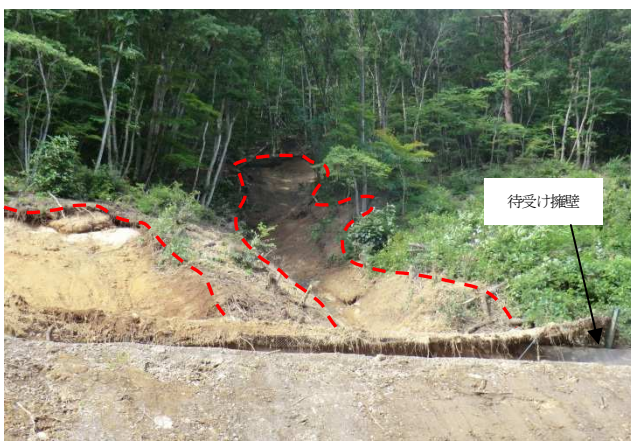
写真 4.27 砂防ダム下流部の山腹崩壊の状況。集水地形を呈する。待ち受け擁壁上部の高さ 1.5m の防護柵をなぎ倒し土砂が道路側に流出。崩壊面には風化凝灰岩が見られる。繫地区では同様の崩壊が多数発生している。
