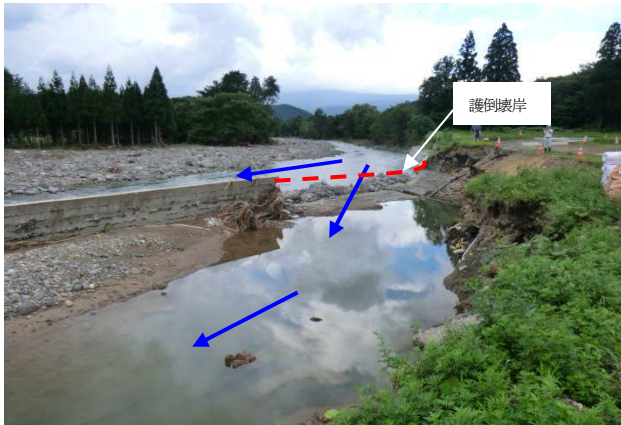
写真 4.20 河川の増水に伴い水衝部護岸の一部が倒壊し、流水がその背面側に廻り込んだ状況。写真の左数百メートルのところに右の写真の鉄橋がある。
