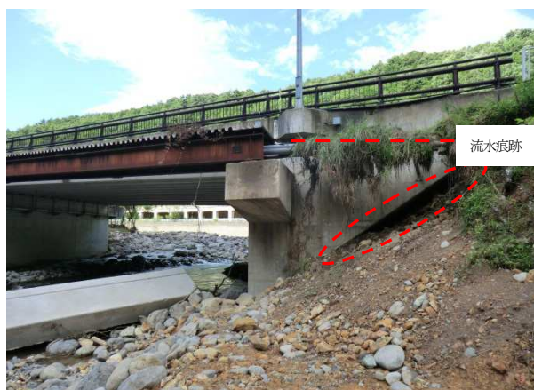
写真 4.12 左岸の護岸の倒壊状況。左岸アバットのウイング部背面が洗掘された状況。水位は橋桁付近まで上昇したものと推察される。
